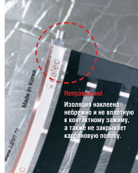
Рис. 13. Пример неправильной установки ПВХ изоляции
