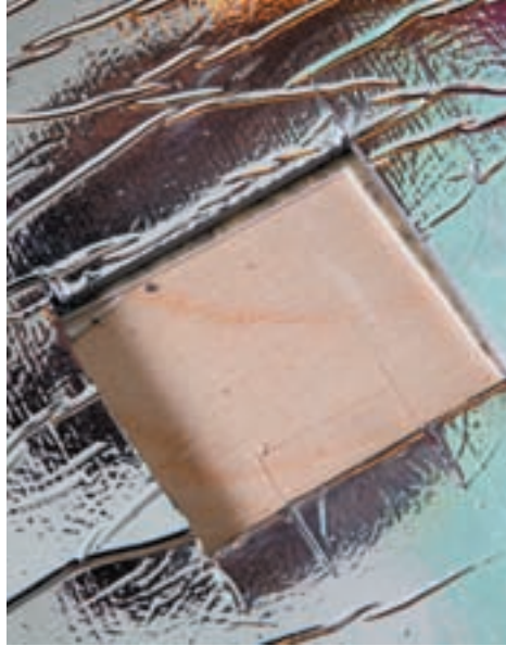
Рис. 22. Отверстие под датчик температуры пола в теплоотражающем материале
